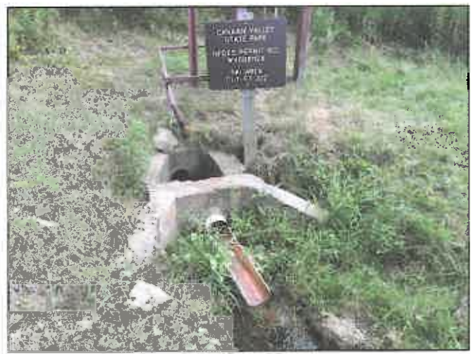
S.E. Flow Meter
